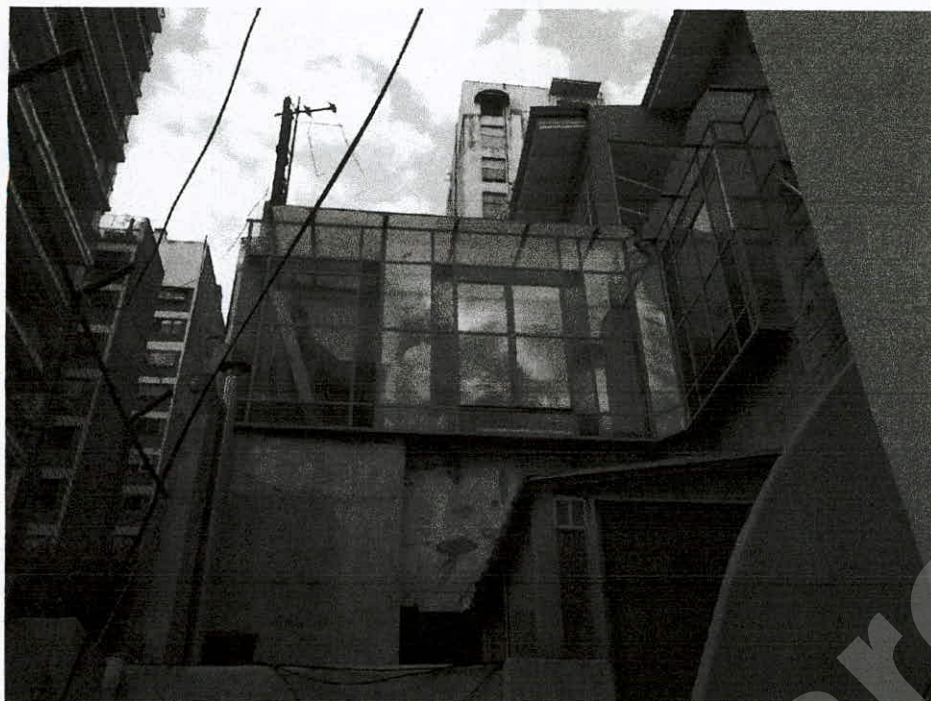
Foto del cerramiento hecho en la UF 17 y los techos y patio del departamento en piso inferior.
